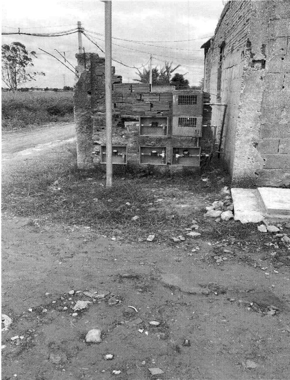
INDIVIDUALIZAÇÃO DE HIDRÔMETROS NA RUA ALAMEDA JUNDIAI, JARDIM SANTOS DUMONT – MOGI DAS CRUZES.
